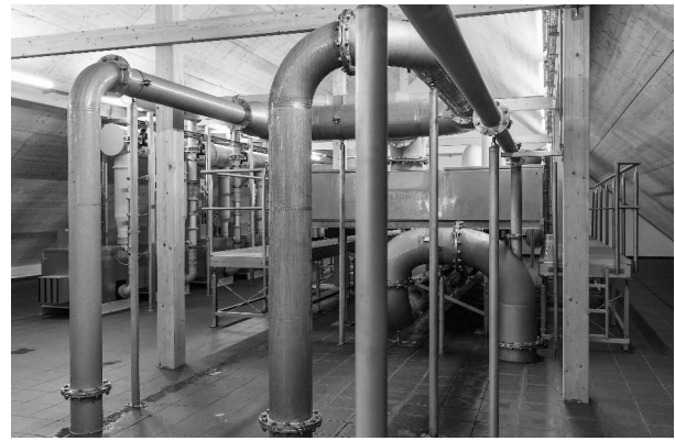
Voll bis unters Dach: Diese Anlage ist für die Entsäuerung des Trinkwassers zuständig.
