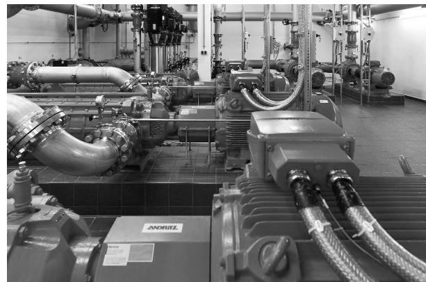
Imposant sind die verschiedenfarbigen Pumpen und Aggregate, die mit unzähligen Rohren und Leitungen miteinander verbunden sind.
